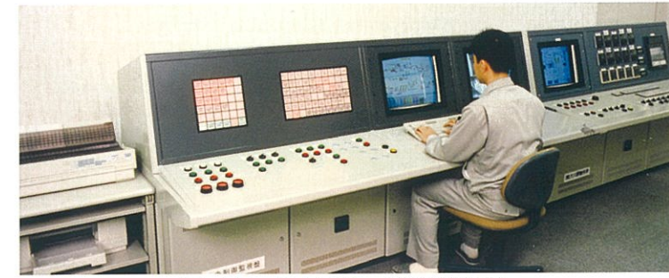
コントロールセンター(中央監視室)
