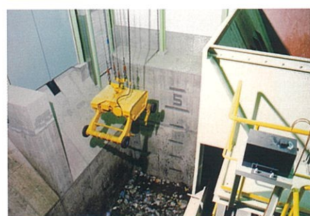
ごみクレーン・ピット
