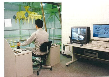
クレーン操作室
