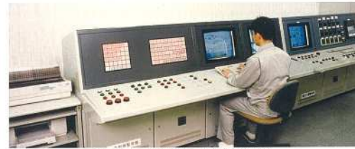
コントロールセンター(中央監視室)
