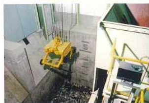
ごみクレーン・ビット
